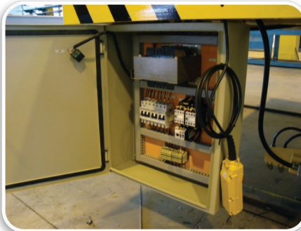
Caixa de controle elétrico
